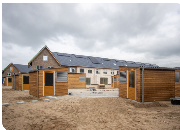
Afbeelding 4. Berging nieuwbouwproject Tiel - buitenluchtroosters naast elkaar
