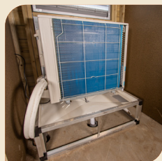
Afbeelding 7. Geïnstalleerde warmtepomp met aluminium tafel met lekbak
